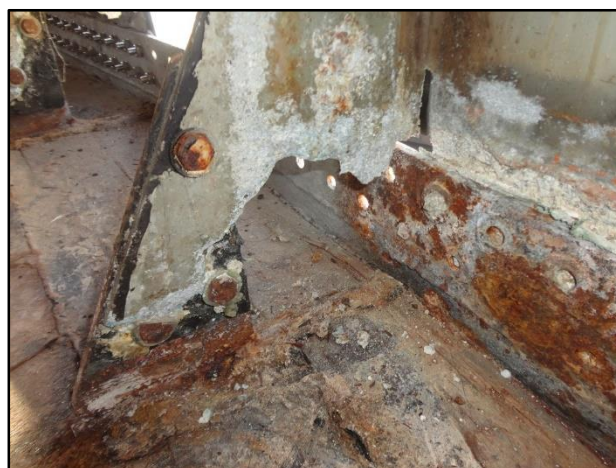
Korrodert aluminium i kapteinssalongen før reparasjon.
