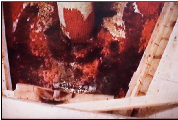
Sprekken var fremme i skarpen, ca. halvveis mellom vannlinja og bakken
